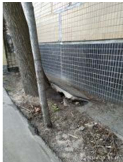
Рис. 7. Рост дерева опрокидывает бетонную плиту
